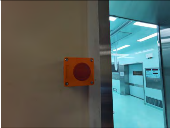
控制间侧墙急停按钮
