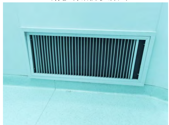
介入 6 室侧墙下沿排风口
