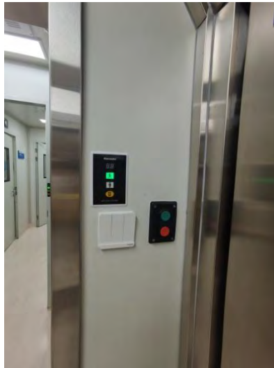
卫生通过间缓冲间互锁装置
