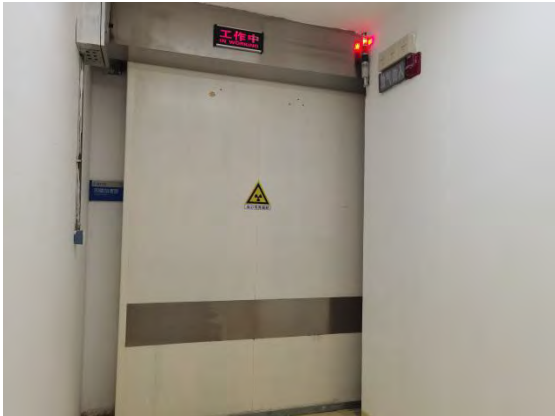
回旋加速器机房防护门
