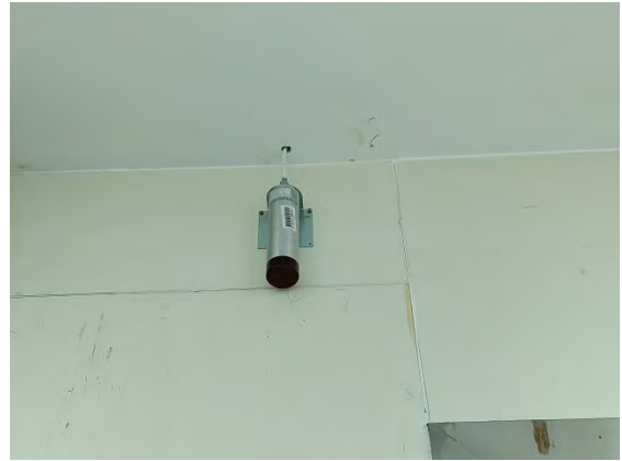
回旋加速器机房内固定式辐射监测探头
