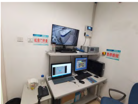
操作控制室内
