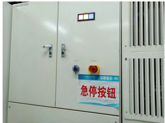
回旋加速器机房内急停按钮
