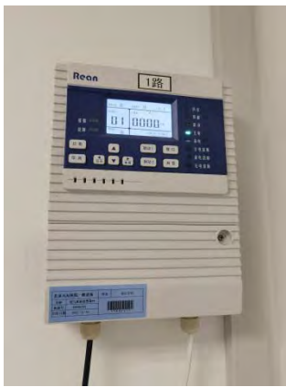
操作台上方氢气泄露报警显示器
