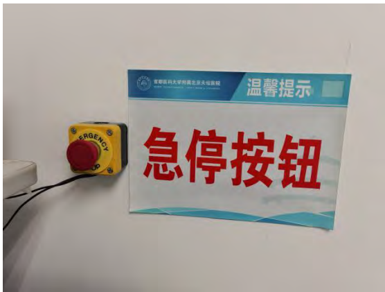
操作控制室急停按钮
