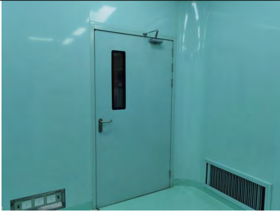
医护人员进出防护门内侧自动闭门装置
